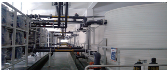
图3 国家风光储输示范工程液流电池储能系统
