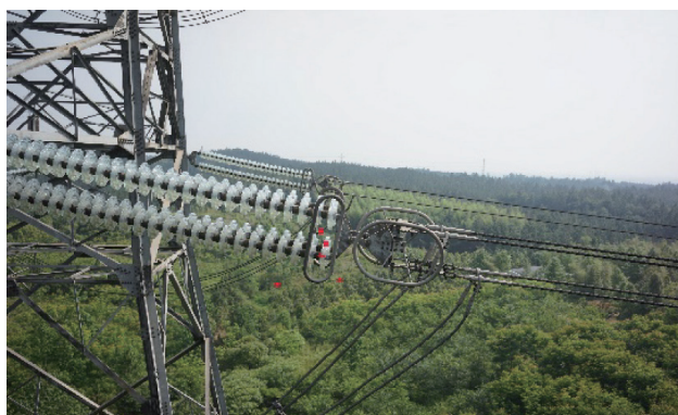
图11 某500 kV线路耐张塔玻璃绝缘子放电
