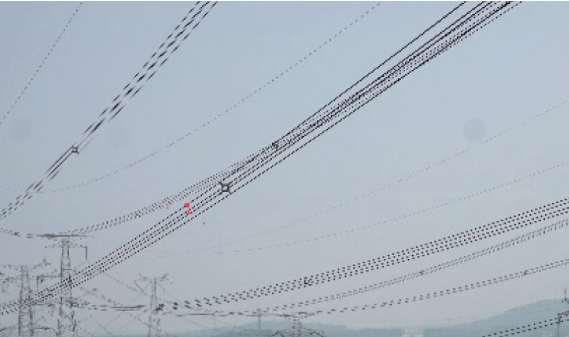
图9 某500 kV输电线路破损放电
