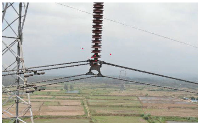
图10 某500 kV瓷质绝缘子放电情况
