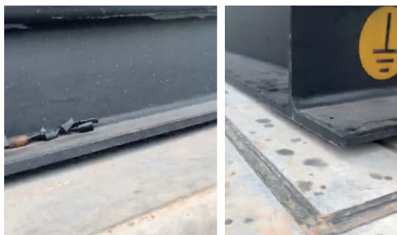
(a) 预制舱底框中部不贴合情况 (b) 预制舱底框四角不贴合情况
