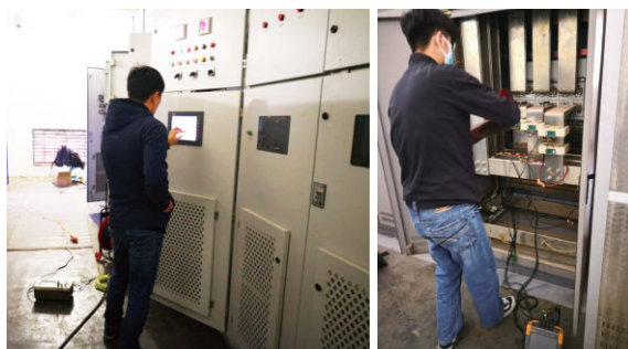
图2 二次及低压回路试验检测
