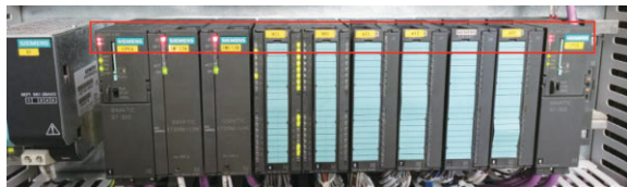
图3 水冷控制系统故障状态
