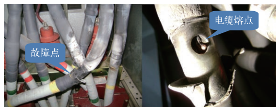
图1 主风机电缆故障图
