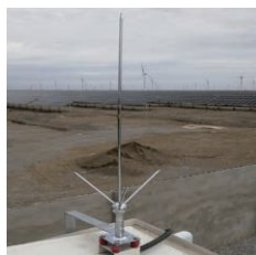
图4 舱顶防雷设计实物图
