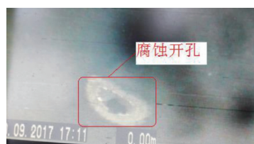
图5 部分泄漏管道：泄漏位置从管板处向内 0.4 m，明显孔洞
