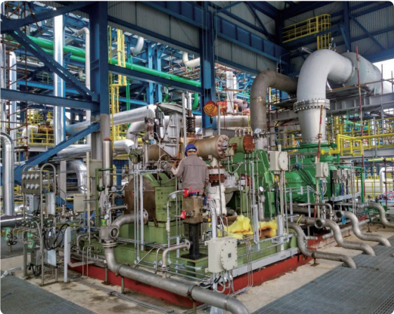
图4 生成气压缩机现场照片
