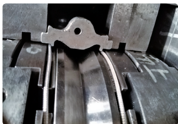
图 1 瓦块顺线槽宽度大和挡油环间隙小
