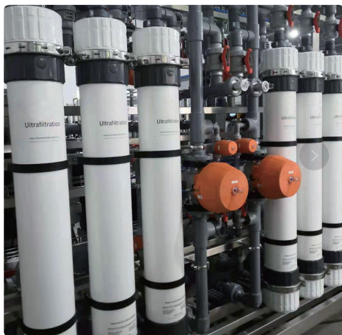
图3 纯化水前处理超滤单元
