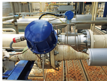
图 2 法兰夹持式 GPro500 现场实际应用
