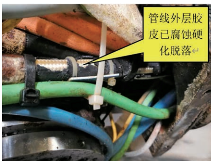
图1 主轴内部腐蚀情况
