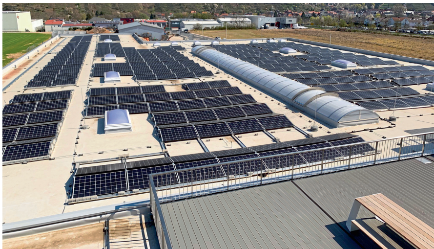
图4 新厂区的光伏系统是气候中和生产措施的一部分
