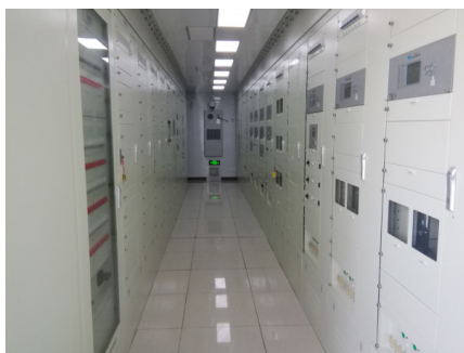
图1 徐州110 kV大宋变电站机架式二次舱
