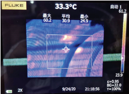
图 2 定子铁心热像图 (修前) Fig. 2 Thermal image of stator core (before repair)
