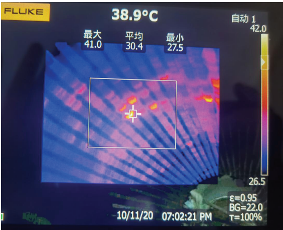
图 3 定子铁心热像图（修后） Fig. 3 Thermal image of stator core (after repair)
