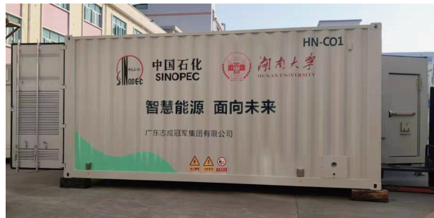
图 7 储能系统实物图
