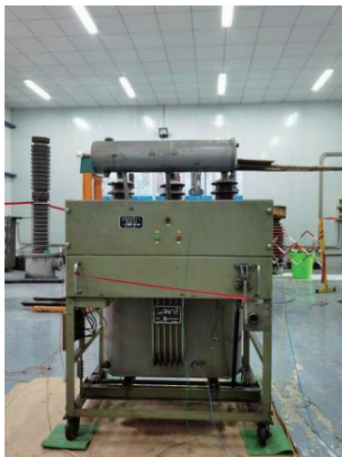
图1 试验变压器 Fig. 1 Test transformer
