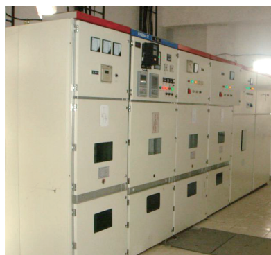
图6 无功降补一拖二软起一次系统实拍照片
