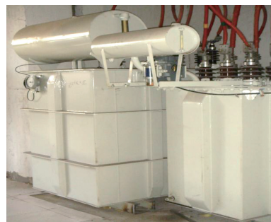
图3 现场实拍降补固态软起动装置照片 (起动 20 000 kW 电动机)
