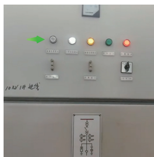
图4 核对相关设备的运行方式
