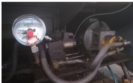
图4 更换后的耐振电接点压力表
