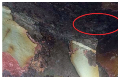
图2 横向小梁腐蚀情况
