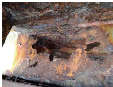
图1 纵向小梁腐蚀情况
