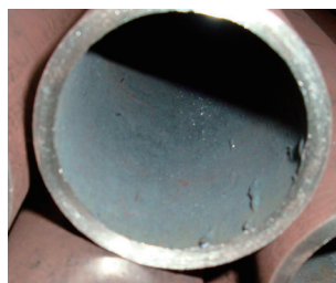
图1 缺陷实物形貌
