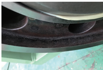
图2 55mm环槽靠近外圆侧底部圆角处裂纹
