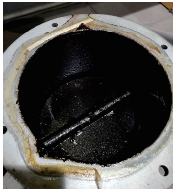
图8 排气管道残留油污
