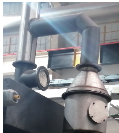
图10 烟道接排油装置
