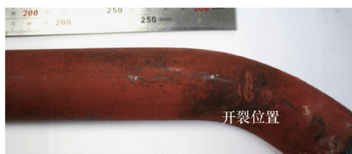
图1 开裂的导热管
