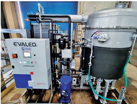
图3 再浓缩蒸发系统实物
