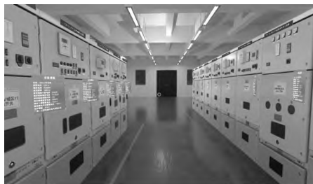
图7 数字孪生变电站开关室智能巡视场景
