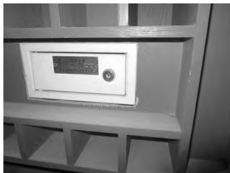
图2 墙体配电箱 Fig. 2 Wall distribution box
