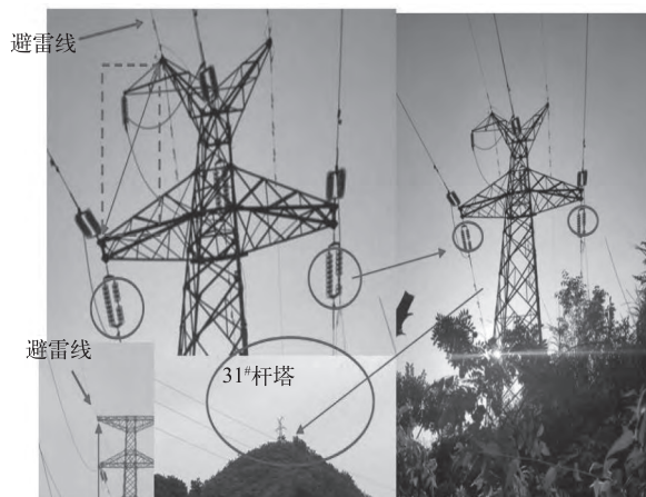
图1 大温线路31 # 杆塔雷击现场
