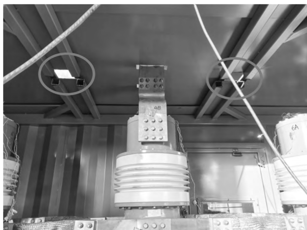
图4 制动开关箱体相间开槽
