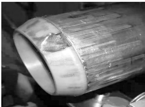
图2 某电站启动开关触头的容性电流烧蚀
