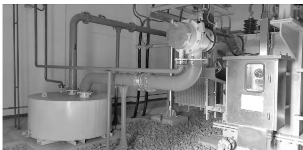
图 17 安装于国内某石化项目
