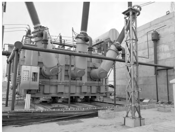
图 16 安装于海外某国项目
