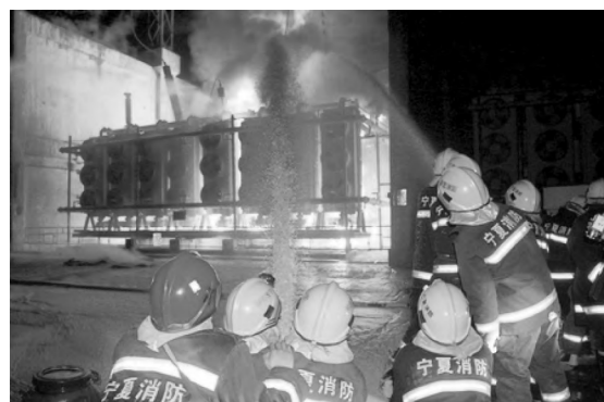
图1 某大型铝厂整流变压器大火
