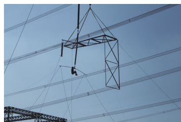
图6 等电位作业人员对上方横担安全距离试验照片
