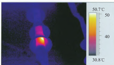
设备名称：35 kV 交联电缆热缩终端 检测仪器：AGEMA570PAL 镜头度数：24 故障类型：热缩不均匀有空气残留
