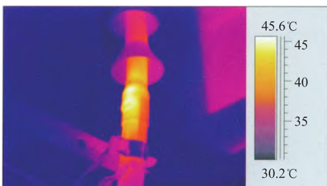
设备名称：35 kV 交联电缆终端 检测仪器：AGEMA570PAL 镜头度数：24 故障类型：接头工艺不良
