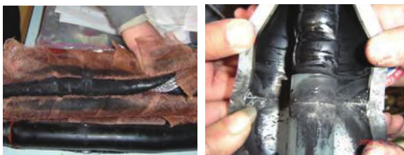
图1 常见的27.5 kV高压电缆故障
