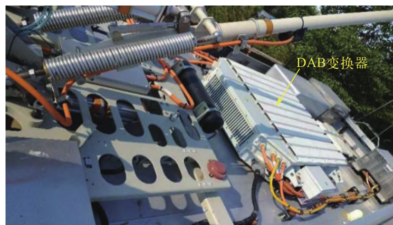
图8 DAB变换器在无轨电车车顶的露天安装
