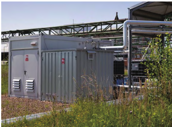
△ 位于比利时奥斯坦德的聚光太阳能热发电场的超压设备：之所以配备这一设备，是因为使用的导热油的体积在使用过程中会随着温度的升高而膨胀
