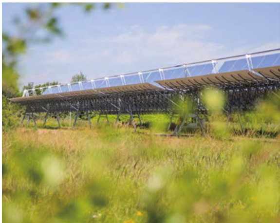
△ Solarlite公司在比利时奥斯坦德建造的聚光太阳能发电站及位于安特卫普港的姊妹发电站，是欧洲工艺领域的第一个聚光太阳能热发电场
