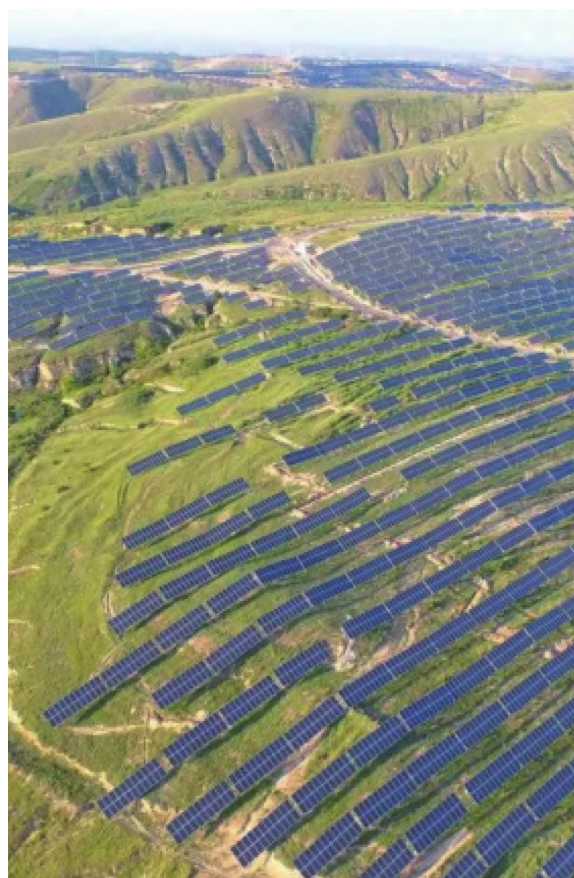
△ 三峡新能源山西大同左云光伏电站
