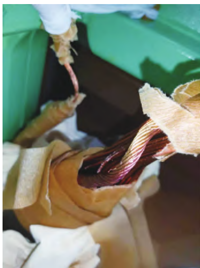
图4 低压绕组故障部位实拍图
