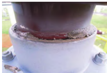
图2 瓷支柱绝缘子断裂处
