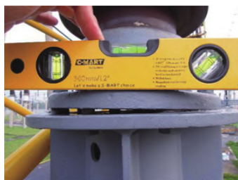
图5 断裂瓷支柱绝缘子底部的水平度
