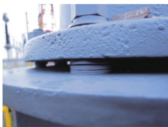
图4 断裂瓷支柱绝缘子法兰盘安装情况
