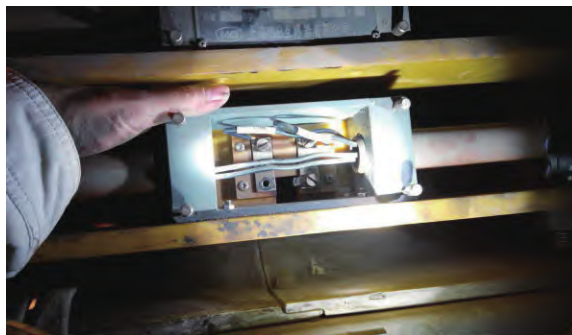
图2 TA二次引线接烧断情况
