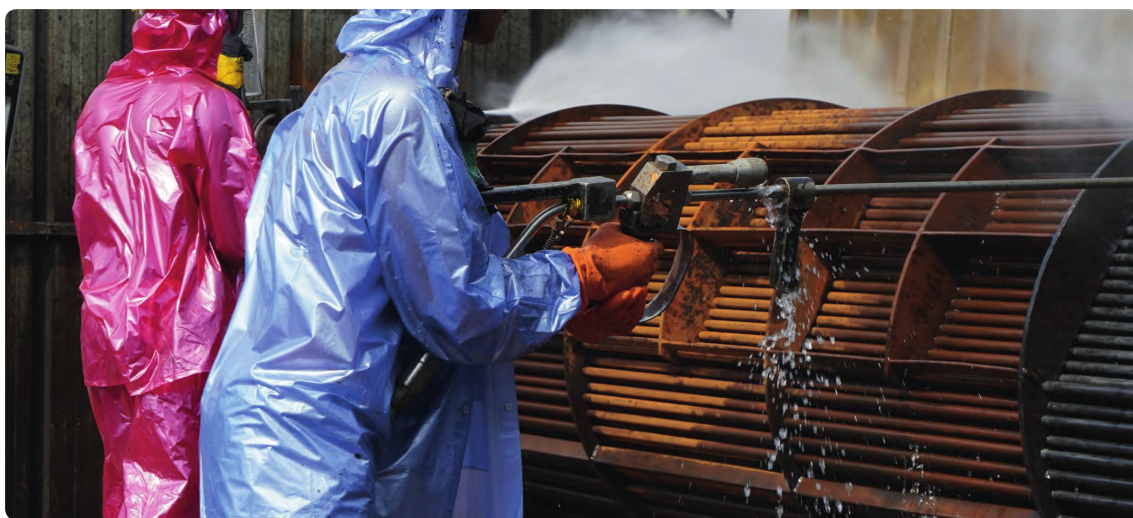
生产残渣、石灰、盐和悬浮物会迅速堵塞管道
