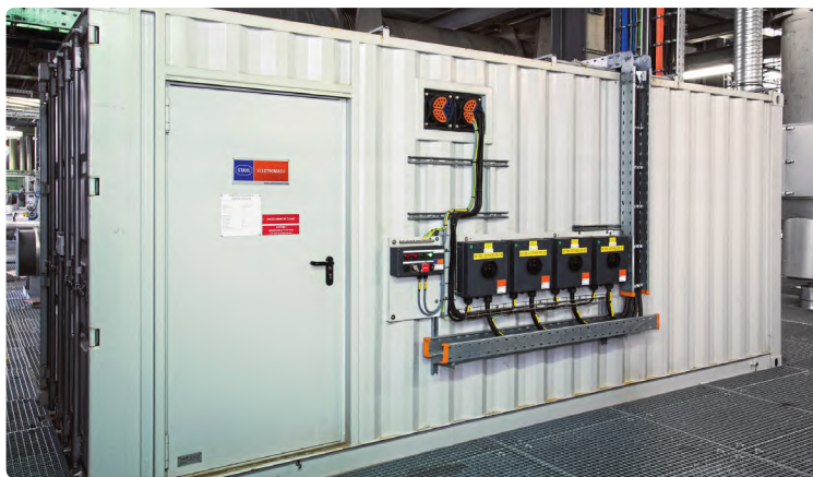
清碳机器人的控制装置安装在3个控制仓中，控制仓防爆等级设计为Ex p-正压型防爆，以确保设备在危险环境中的安全性
