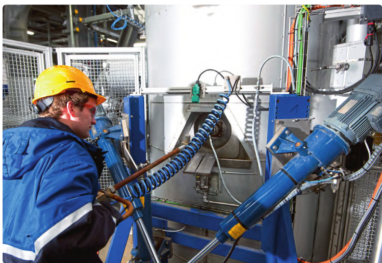
在紧急情况下，例如发生电源故障时，工作人员可以停用机器人执行机构，手动操作清碳杆，这也确保了燃烧室维护的手动操作
