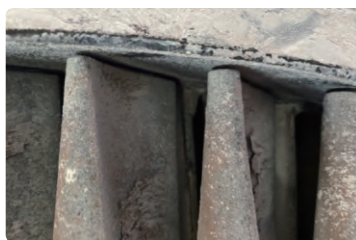
图10 2 # 催化烟机运行874天情况1 (2020年4月检修)
