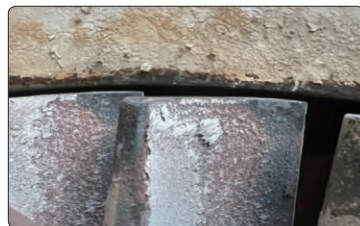
图7 1#催化烟机运行313天情况2 (2021年11月检修)
