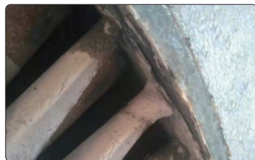
图6 1#催化烟机运行313天情况1 (2021年11月检修)
