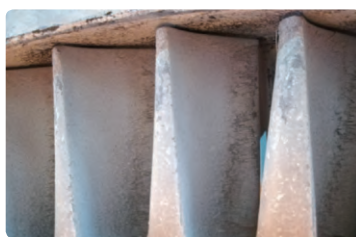
图8 2 # 催化烟机运行199天情况1 (2017年11月检修)
