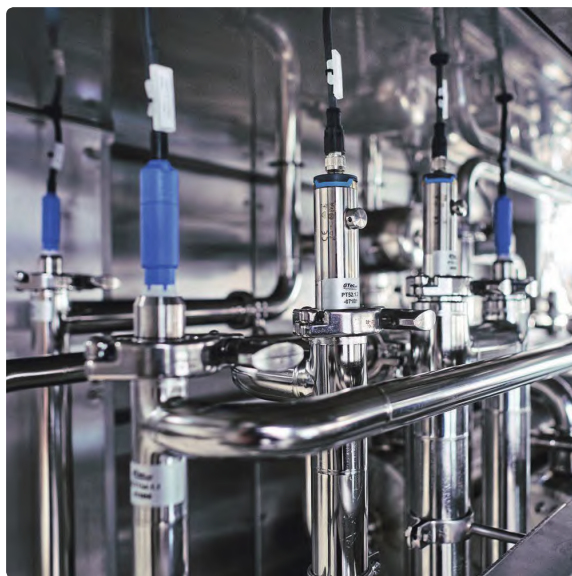
在 GTec 的工厂里，自来水正在变成超纯水，这离不开 Lapp 的连接技术
