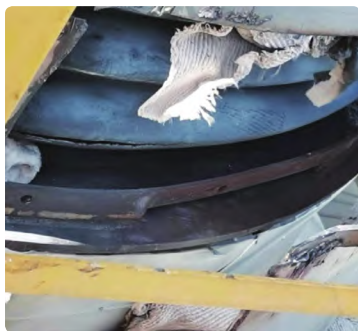
图1 波纹管波峰开裂
