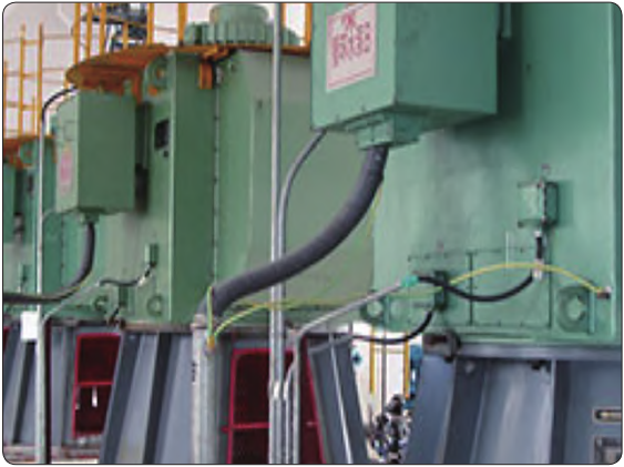
图 7 立式筒袋式凝结水泵现场图
