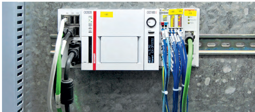
图 2 安装在卡槽中的嵌入式 CX2020 计算机可以当做逻辑控制器和通讯服务器使用；它还支持现场操作和远程维护
