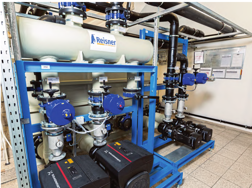
图 1 总体而言，新系统提供高达 500kW 的再冷却能力，并确保在高达 35℃ 的外部温度下达到所需的工艺温度
