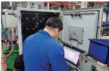
图2 AGV网关通信测试
